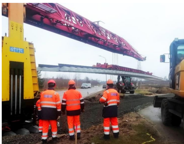
10 pav. Geležinkelio atšakos į Šiaulių miesto pramoninę zoną įrengimas. Vitalio Lebedžio nuotrauka
